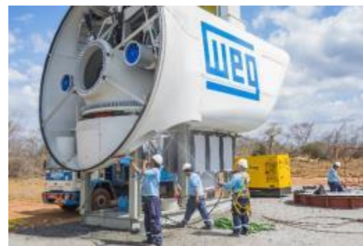
Projeto Bons Ventos da Serra I Ibiapiabina – CE 11 Aerogeradores AGW 110/2.1 23.1 MW Instalados
